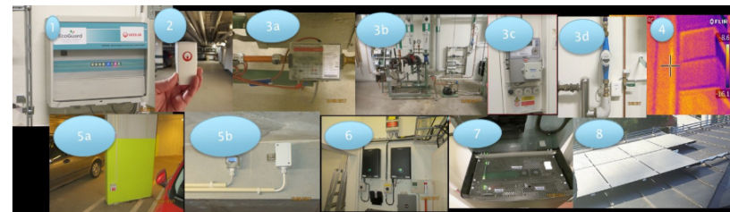
Figura 27: Tecnologias instaladas em Årstakrönet (1) Sistema adaptativo para controle do aquecimento; (2) Controle da temperatura interna em cada apartamento; (3) Medidas implementadas para: perdas na circulação de água quente (a), energia térmica no distrito (b), eletricidade (c) e água fria (d); (4) Controle termográfico; (5) Controle inteligente da ventilação na garagem: PPM (a) e temperatura e umidade (b); (6) Hub elétrico instalado; (7) Armazenamento de bateria elétrica instalado; (8) Células fotovoltaicas e sistema de controle instalado.
